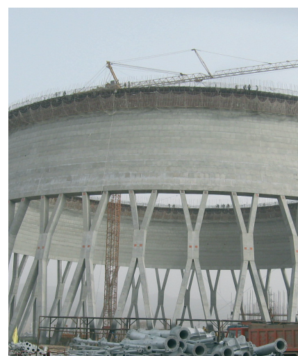
2 x 660 МВт Угольная электростанция Zuoquan, Китай - 2012
